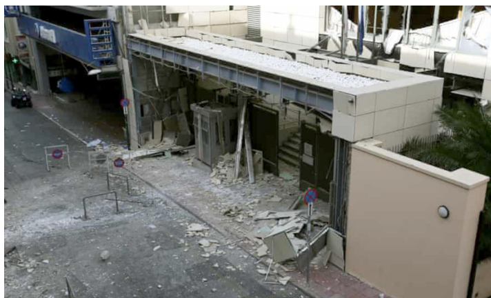
Zdjęcie 2. Uszkodzenia ambasady Cypru po zamachu
